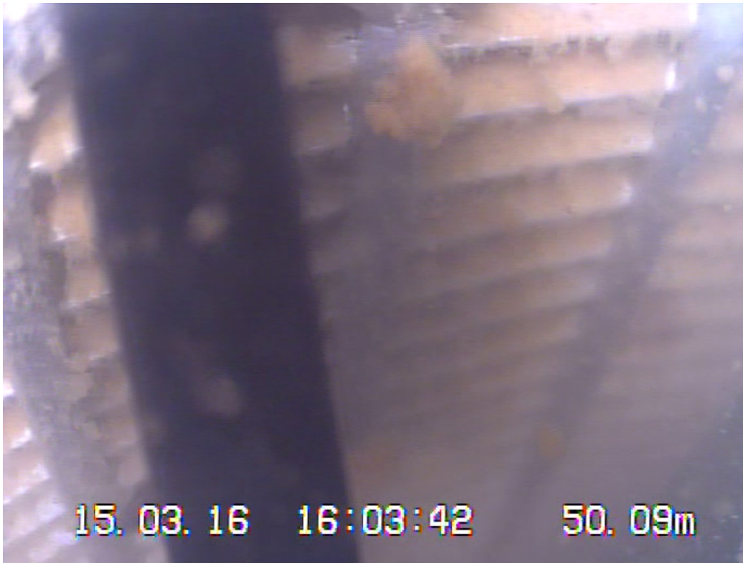
Abbildung 22: Fe(OH) 3 -Ausfällungen nach Sauerstoffeintrag in der Integralsonde Berlin-Südwest vor der Reparatur.
