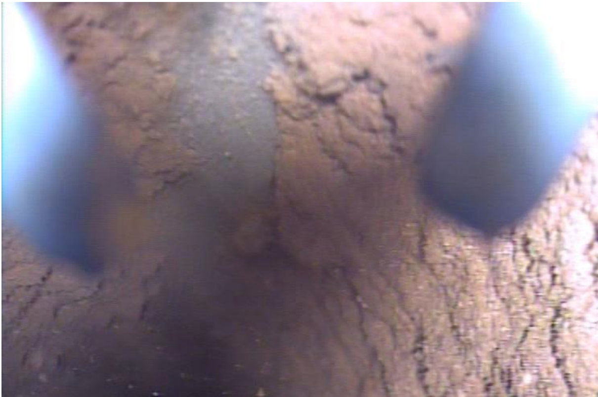
Abbildung 25: Innere Verockerung des Schluckbrunnen in 44 Metern Tiefe
